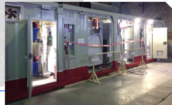
АВЭМ с трансформатором
